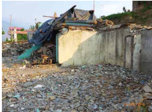
Zerstörung im Dorf Manekharka
