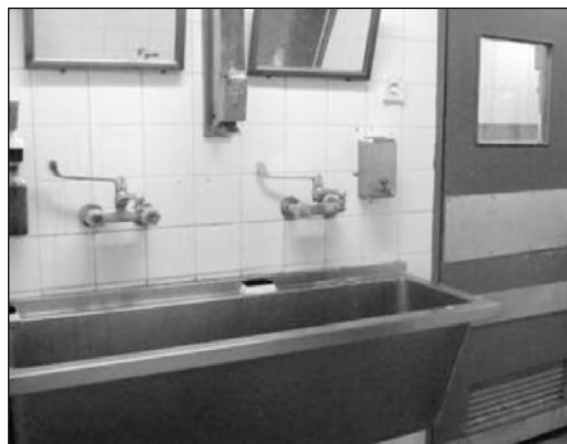
Figura 17. Zona de lavado quirúrgico, «scrub área».
